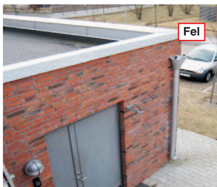
Bild 3: Olämplig utformning av avvattning av varma tak: Utkastare genom takkrön.
