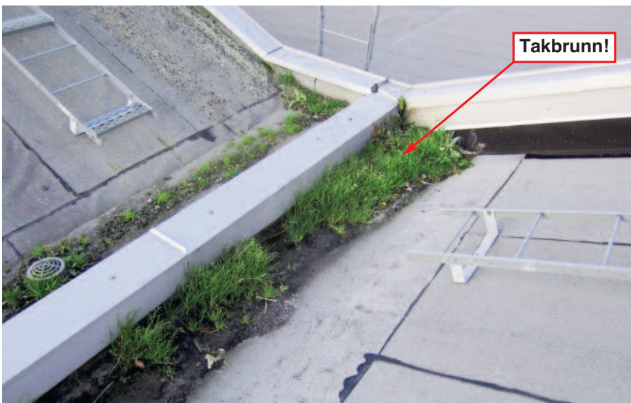
Bild 12: Bristande tillsyn: Takavvattningsbrunn är helt dold av jord och gräs.
