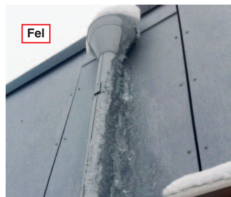
Bild 4: Konsekvens: Smältvattnet från taket fryser i stupröret på utsidan och stoppar fortsatt avvattning.
