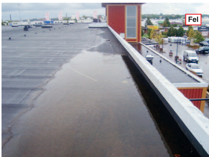
Bild 7: Takbrunn har satts igen av löv och skräp. Uppbyggnaden med rännalskilar mellan takbrunnarna hindrar vattnet från att rinna vidare till nästa takbrunn. Bräddavlopp saknas.
