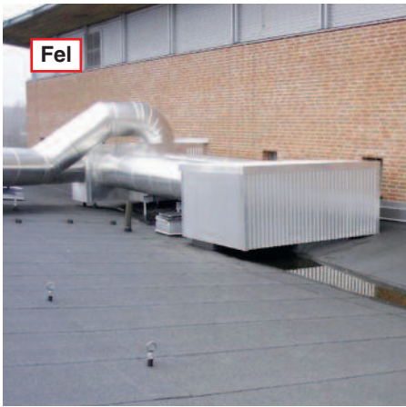
Bild 11: Exempel på olämplig placering av installationer: Mitt i rännaldalen!
