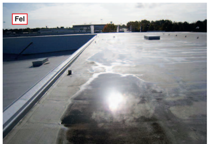
Bild 8: Brunnar ej placerade i takets lågpunkter leder till stora mängder kvarstående vatten. För att lösa problemet har rännalskilar monterats mellan takbrunnarna, som synes utan resultat. Rätt lösning hade varit att placera takbrunnarna i takets naturliga lågpunkter: mitt emellan pelarna.
